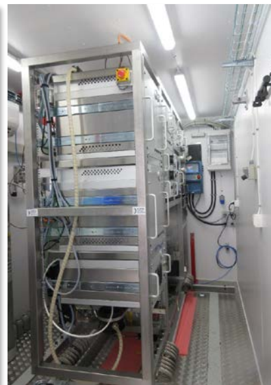
幌延町での設置と室内の様子
